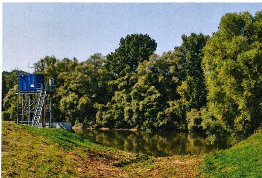
6. fénykép. 2024 augusztusától vízhiány elleni készütség keretében üzemeltetjük a Rétközi vízpótló szivattyútelepet
