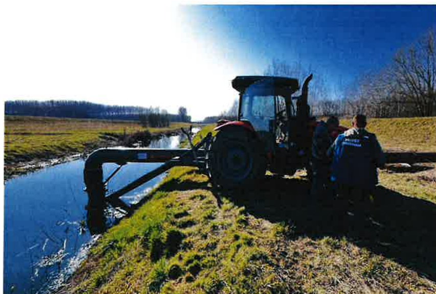
6. FÉNYKÉP. MOBIL SZIVATTYÚS VÍZKIVÉTEL A LÓNYAY-FŐCSATORNÁBÓL, A NAGYHALÁSZI HALASTAVAK VÍZPÓTLÁSA ÉRDEKÉBEN, 2025 TAVASZÁN
