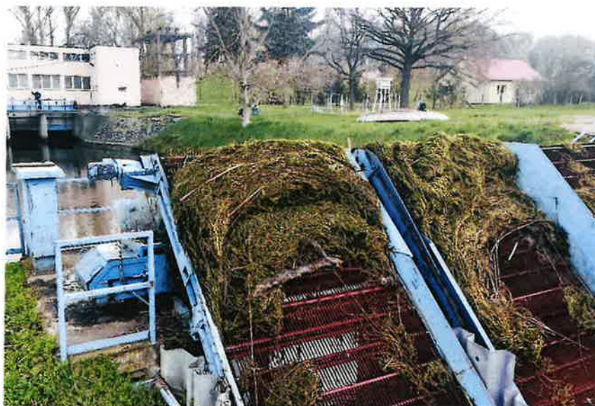
4. FÉNYKÉP. MOZGÓGEREBRE ÉRKEZETT NÖVÉNYI HULLADÉK KISZEDÉSE A TISZABERCELI SZIVATTYÚTELEPEN
